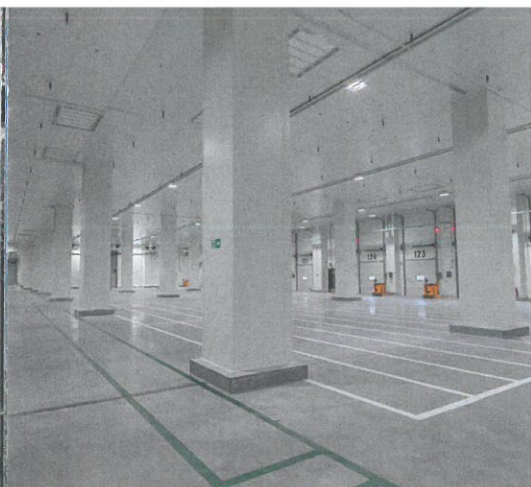
▲ Obr. 5 Pohled do chlazeného skladu
