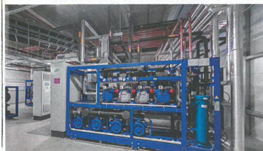
▲ Obr. 11, 12 Strojovna chlazení
